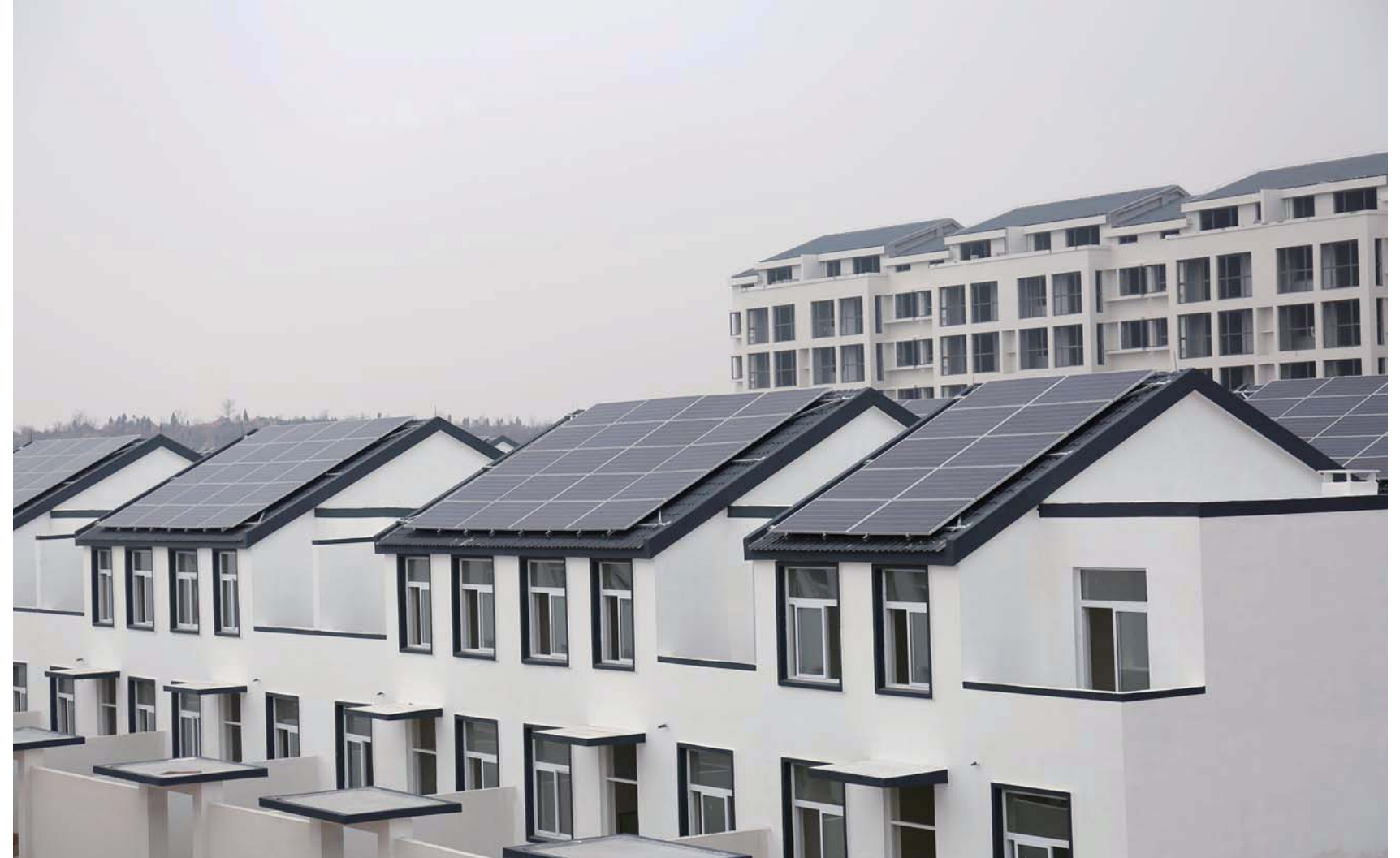
晶科科技海宁市袁花镇家庭光伏电站扶贫项目
