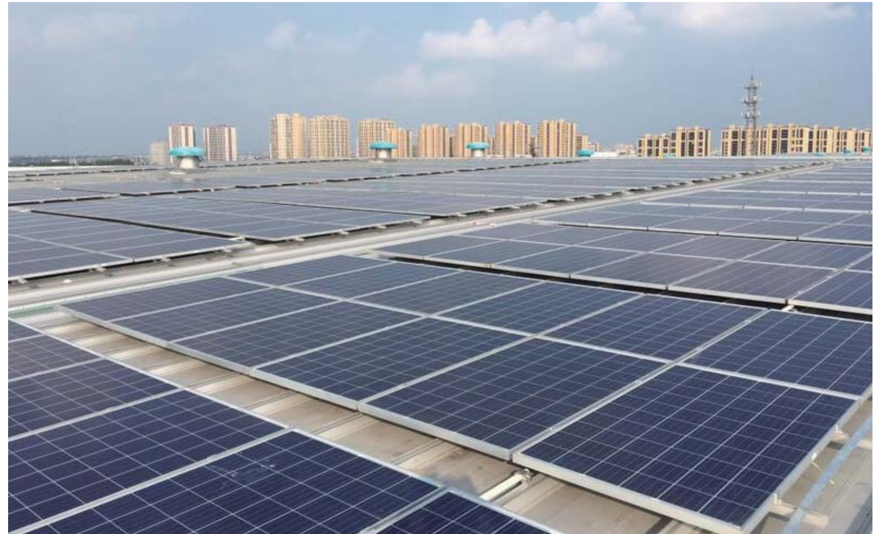
上海京东1.2兆瓦屋顶分布式项目
