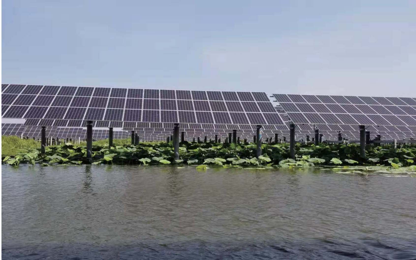
江苏扬州宝应光伏发电应用领跑基地2号100兆瓦项目
